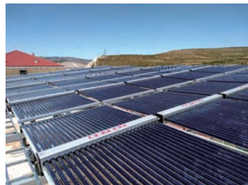
改造后的太阳能电辅热锅炉
