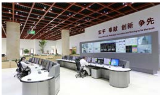
北京燃气集控中心
